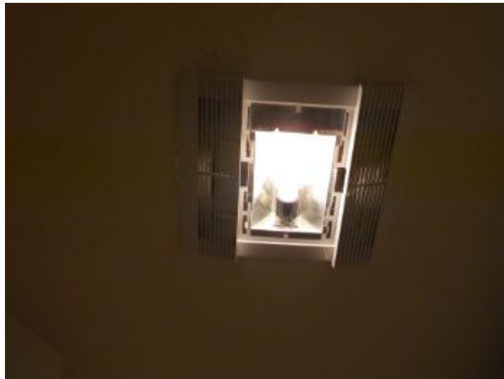
Exhaust fan unplugged
